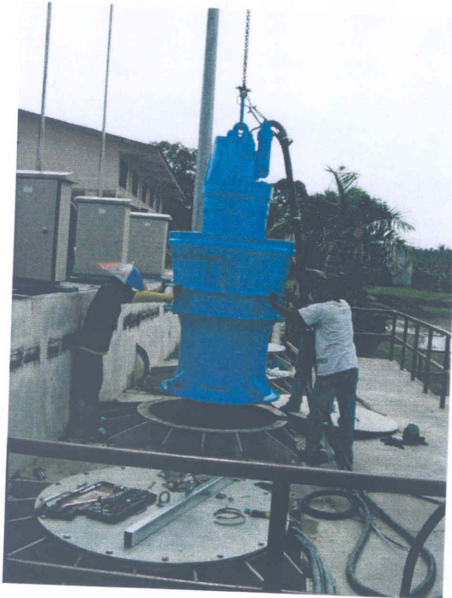
Kerja-kerja pembaikan yang dijalankan setelah kerosakan yang dikenalpasti.
