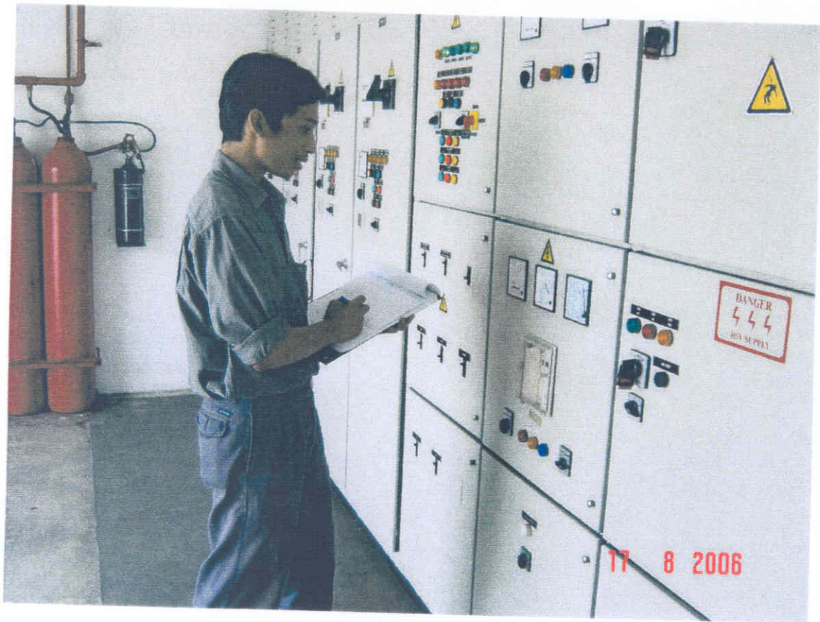
Pemeriksaan rumah pam pada panel kawalan.
